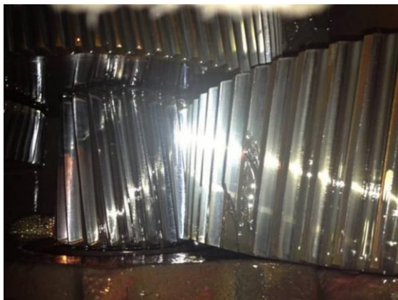
图3 3.5 张力辊齿轮箱齿面崩裂痕迹
